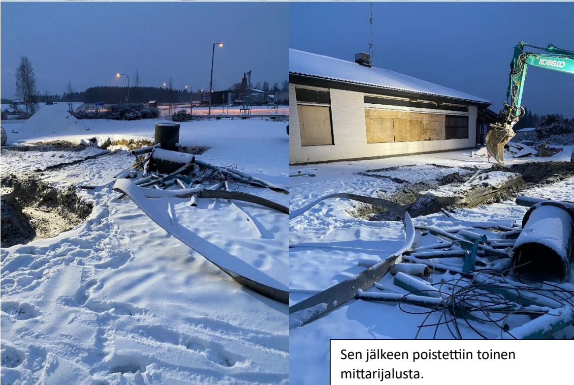
Ensin poistettiin kaivo, sen jälkeen mittarijalusta sen vierestä. Pilaantunutta maata poistettiin kaivon ympäriltä ja jalustan alapuolelta.
