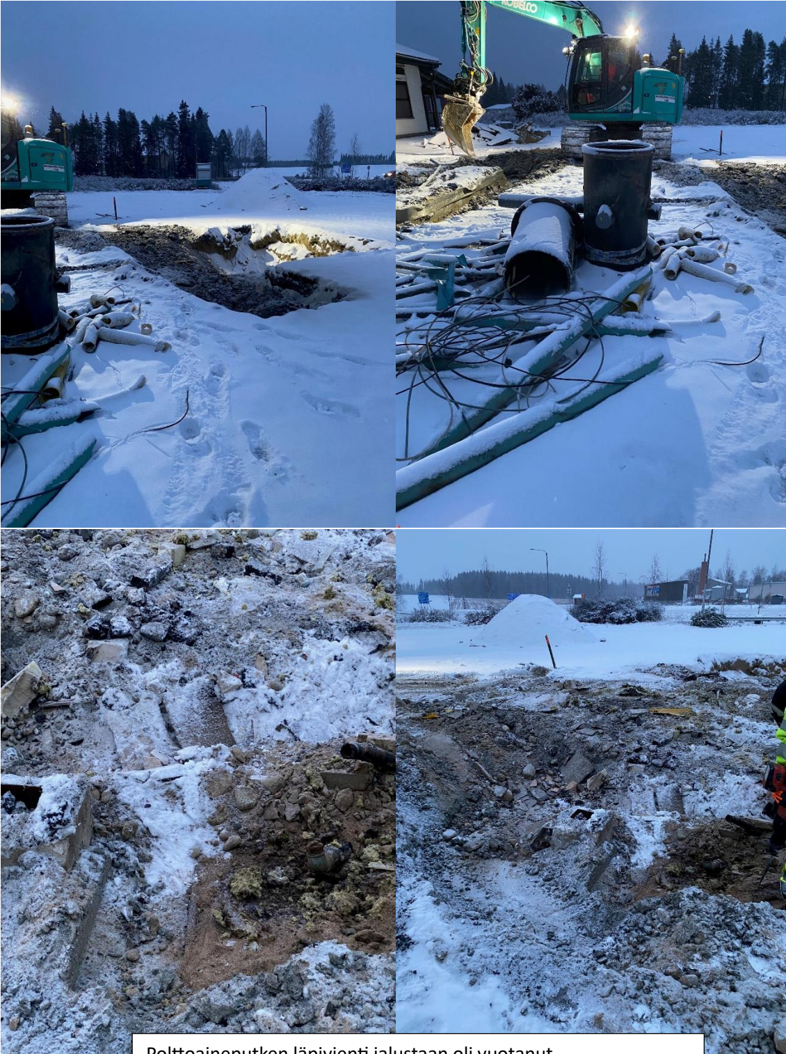
Polttoaineputken läpivienti jalustaan oli vuotanut.
